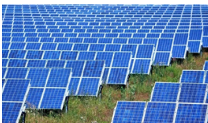
СОНЯЧНА ЕЛЕКТРОСТАНЦІЯ ООО «СОЛАР ЕНЕРЖІ-СКІФ» Вінниця 2019
